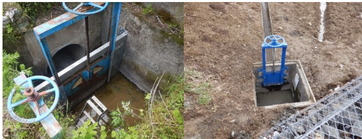
農業用簡易取水ゲート
