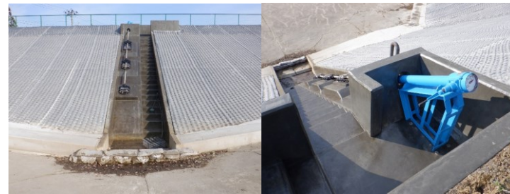
ため池取水設備
