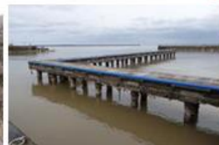
1/22 輪島市(輪島港) (隆起により接岸不可)
