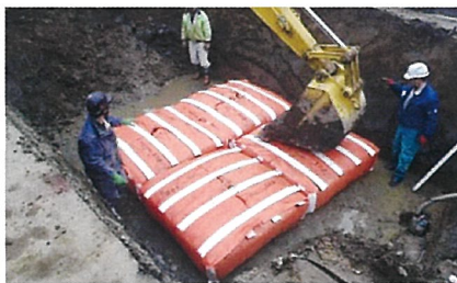
⑤ 敷設箇所にてバックホウで加圧し地盤内に入らせる
